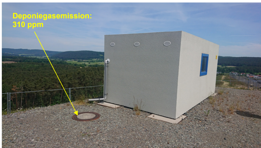
Bild 2: Gasunterstation GUS B mit Kondensatschacht
